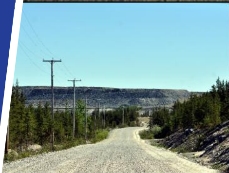
Ligne électrique de 60 km, routes du site et traversées de cours d'eau
