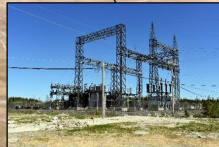
Poste électrique de 50 MW
